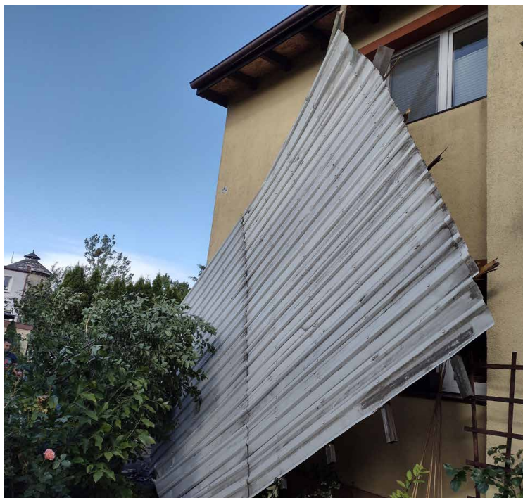
Zerwany dach garażu zawisł na domu sąsiada. Fot. OSP Skoki
