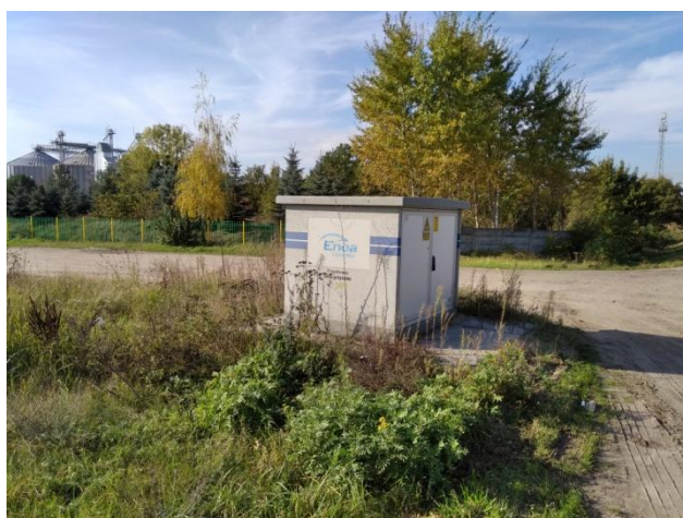
12. Zachodnia część obszaru opracowania – widok na stację transformatorową
